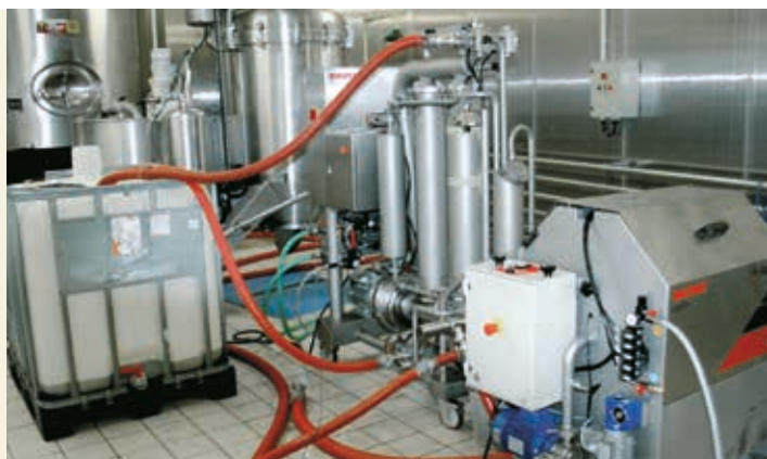
Installation de filtration des bourbes
